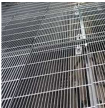
Fig.1 グレーチング床
